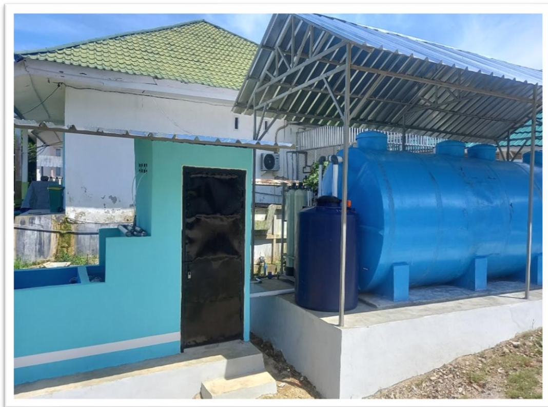
Instalasi IPAL RSUD Trikora Salakan
