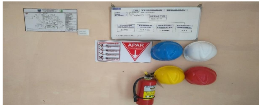
Perlengkapan APAR RSUD Trikora Salakan
